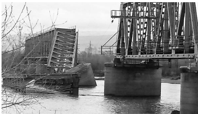
Рис. 18.5. Обрушение двух пролетов моста через реку Абакан из-за подмыва опоры
